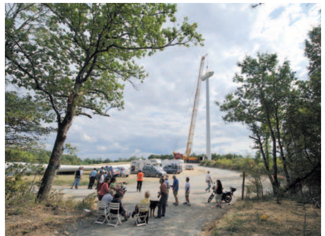
Eine Attraktion für die Nachbarn war im vergangenen Jahr der Aufbau des Windparks Cuq im südfranzösischen Département Tarn et Garonne.
